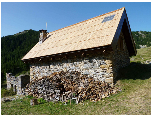
Réfection de la toiture du refuge de service de Vignols (Moyenne Tinée)
